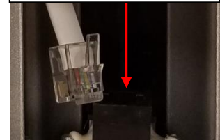
Cable de celda de carga no conectado
